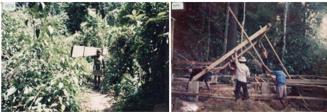
Gambar 2. Pekerja bangunan membawa papan kayu dari luar kawasan TNBBS (kiri) dan proses pembangunan stasiun penelitian pada tahun 1997 (kanan).
